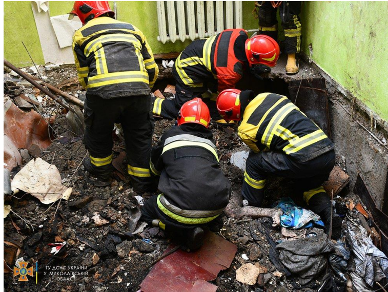
Фото 2.22 Проведення робіт з деблокування тіла загиблого з під уламків будівлі
