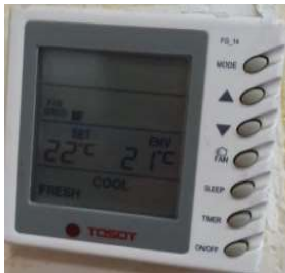
Рис.4.3. Електронний термометр TOSOT для вимірювання температури повітря
