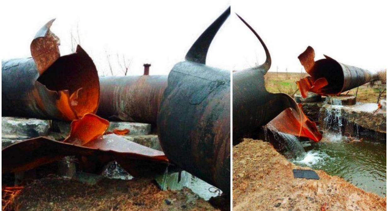
Рис. 1.3. Пошкоджена ділянка водоводу "Дніпро-Миколаїв" [28].
