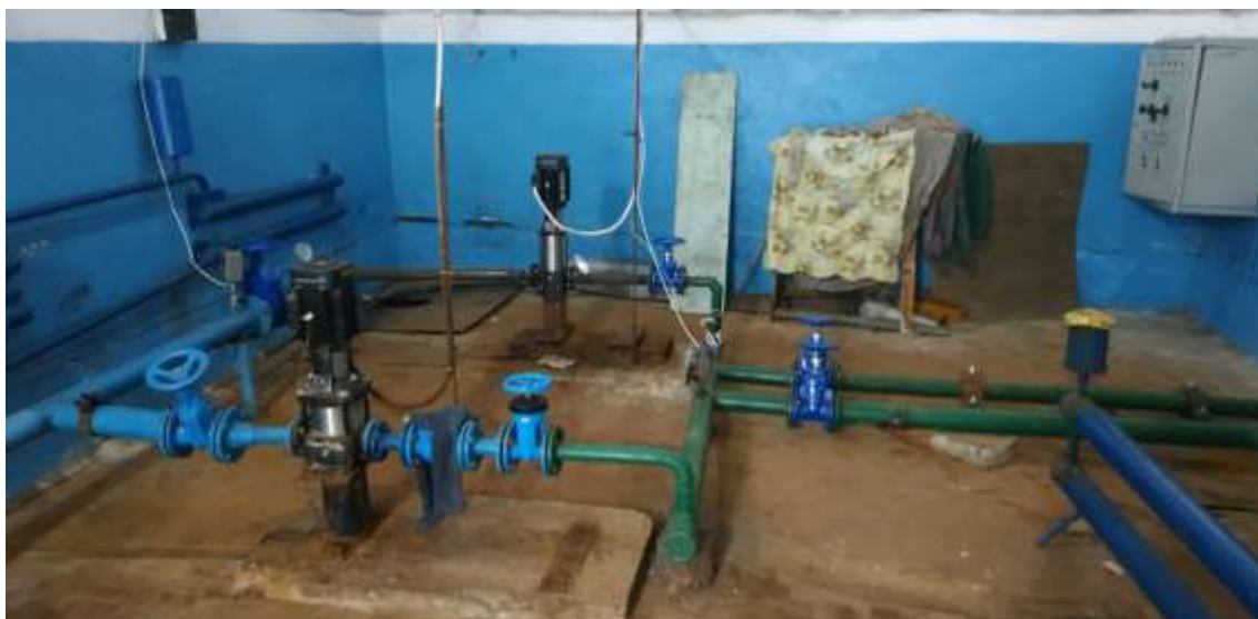
Рисунок 4.2 – Вигляд приміщення машинного залу насосної станції
