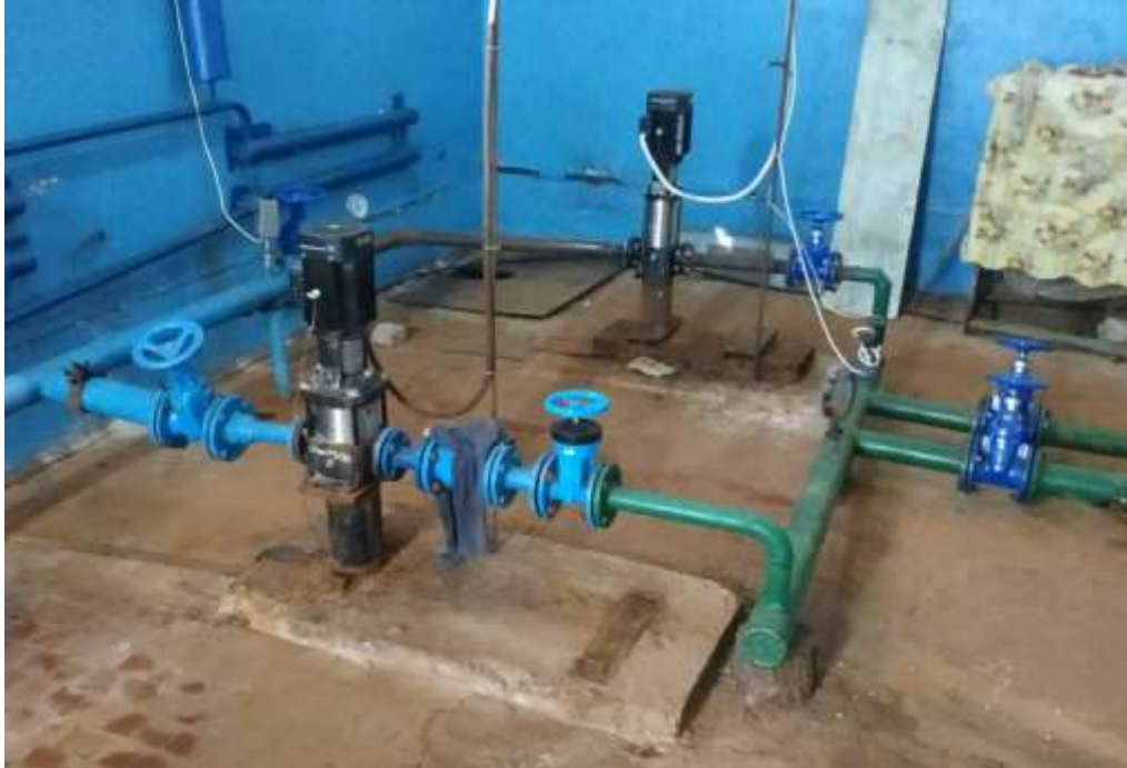
Рисунок 1.18 – Загальний вигляд приміщення насосної станції з її технологічним обладнанням
